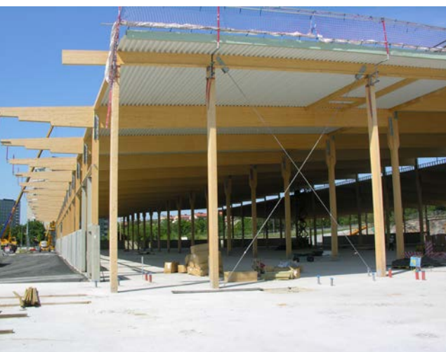
Limträhall under uppförande. Permanent vindkryss i ena gaveln för ner horisontella laster från styv takskena av trapetsprofilerad plåt till grunden.
